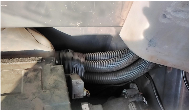
duto de saída superior esquerda da cabine paralelo
