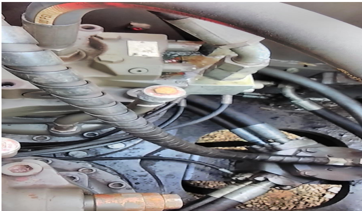
vazamento no motor de giro lado esquerdo
