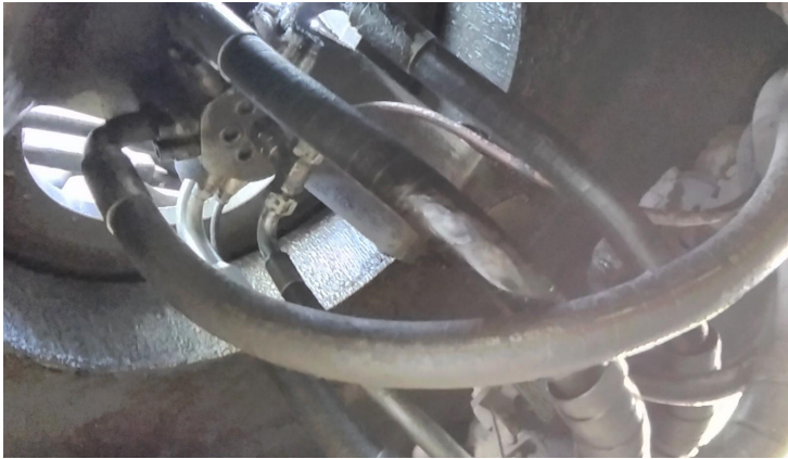
mangueras do swivel danificadas
