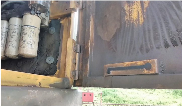
falta trava da tampa do compartimento das bombas hidráulicas
