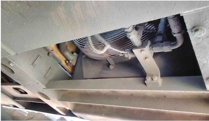
falta tampa proteção inferior da hélice
