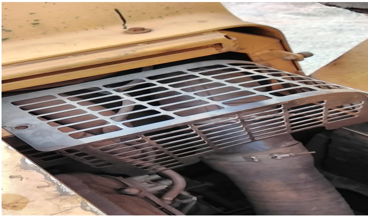
falta trava da tampa traseira do motor diesel
