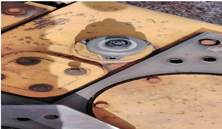
válvula de respiro do tanque hidráulico danificado
