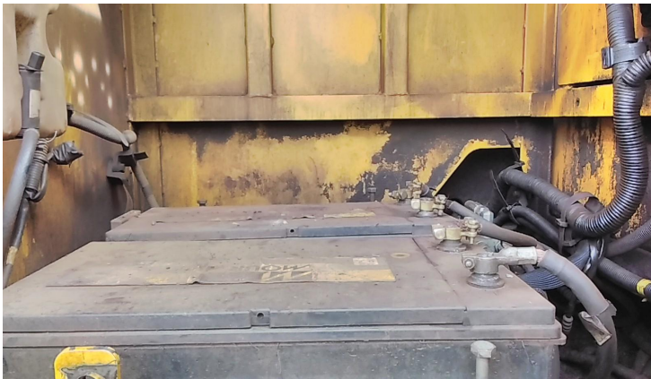
equipamento com baterias danificadas
