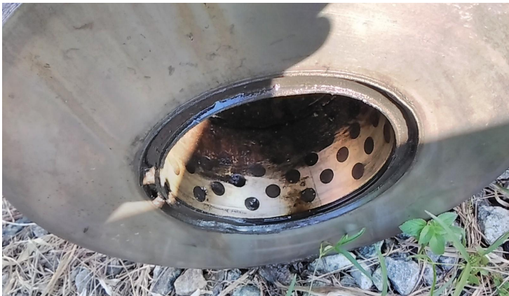
buchas da base da lança danificadas
