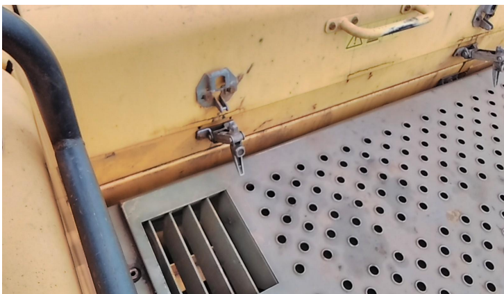
tampa do compartimento do motor diesel danificado
