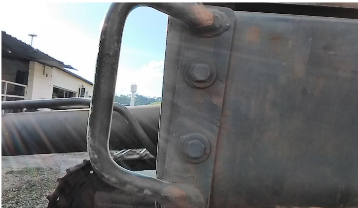
corrimão do carro e superior danificado
