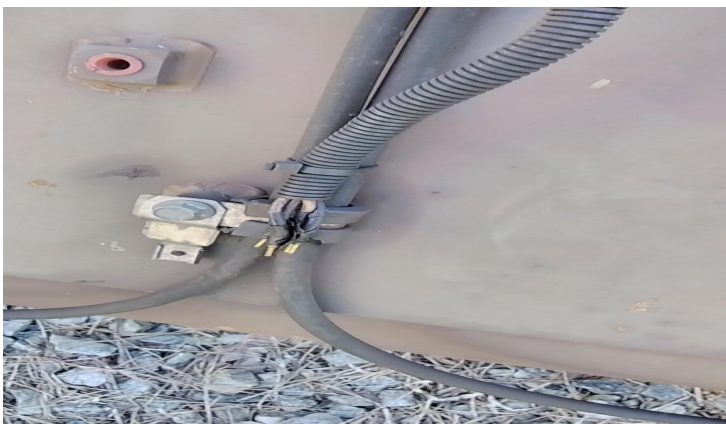
chicote dos faróis da Lança danificado
