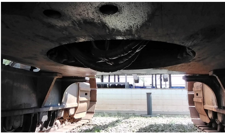
falta tampa proteção do swivel
